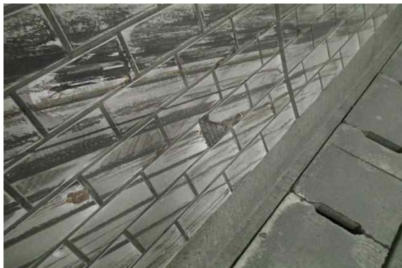
측벽부 SPAN.40 타일파손
