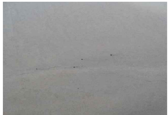
라이닝 SPAN.69 종방향 균열(0.3mm미만)
