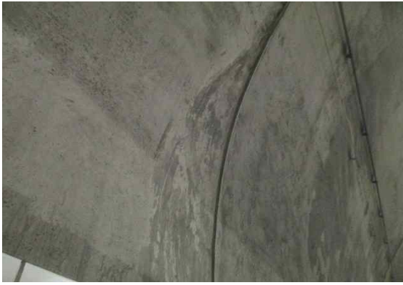
라이닝 SPAN.13 균열(0.3mm미만)
