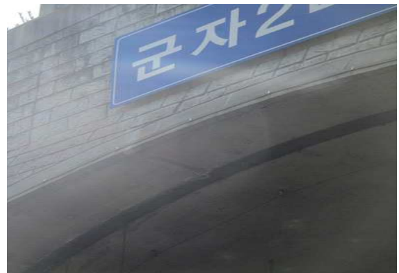
종점부 갯문 균열보수현황
