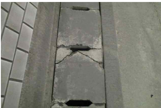
공동구 SPAN.32 덮개 파손
