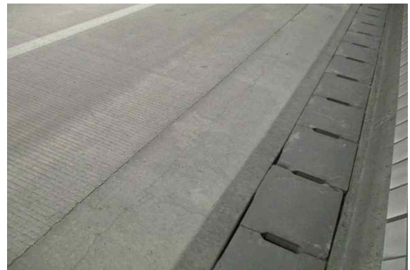
포장부 SPAN.19 균열(0.3mm 이상)
