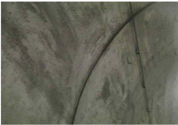
라이닝 SPAN.20 균열(0.3mm미만)
