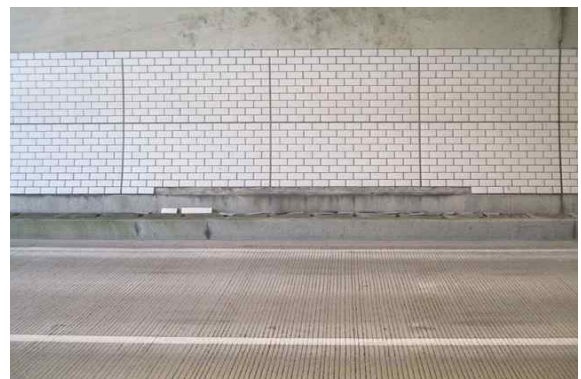
측벽부 SPAN.105 타일탈락
