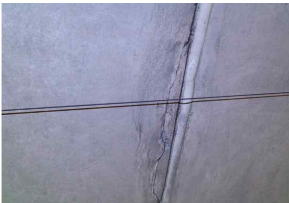
라이닝 SPAN.60 조인트부 들뜸
