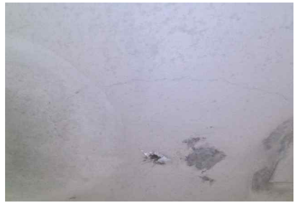
라이닝 SPAN.58 횡방향 균열(0.3mm미만)
