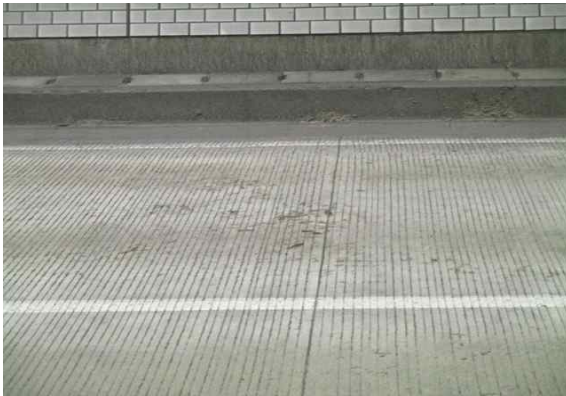
포장부 SPAN.66 이물질내재
