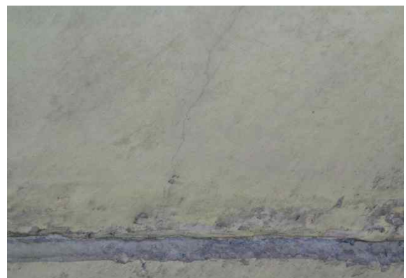
라이닝 SPAN.102 종방향 균열(0.3mm미만)
