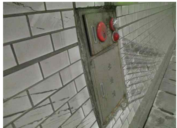
SPAN4 소화전 파손
