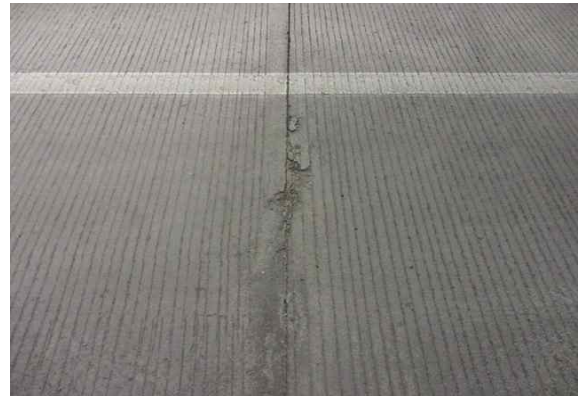
포장부 SPAN.65 파손
