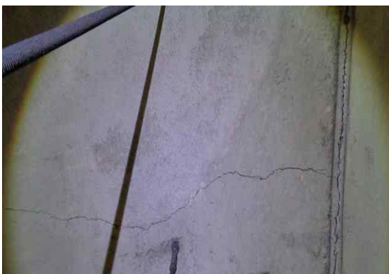
라이닝 SPAN.100 종방향 균열(0.3mm이상)
