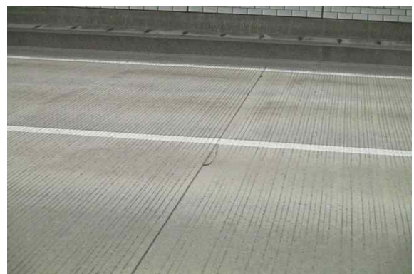
포장부 SPAN.22 파손
