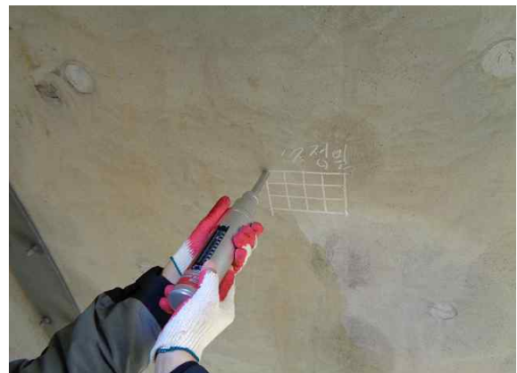
반발경도 측정 현황(측벽부)
