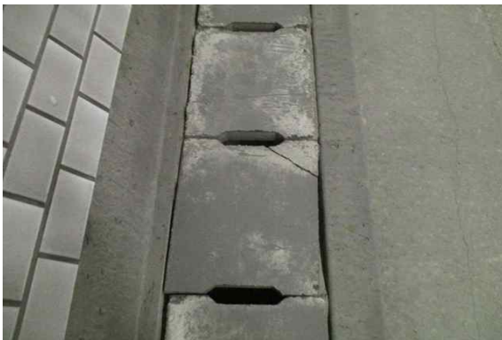
공동구 SPAN.20 덮개 파손
