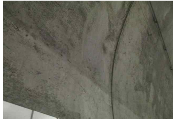
라이닝 SPAN.18 균열(0.3mm미만)
