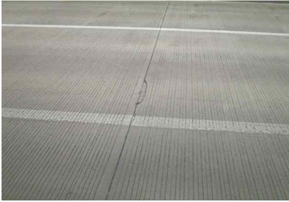
포장부 SPAN.23 파손
