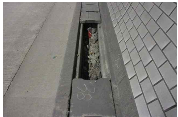
공동구 SPAN.38 덮개 탈락
