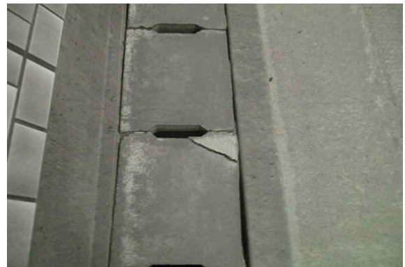
공동구 SPAN.22 덮개 파손
