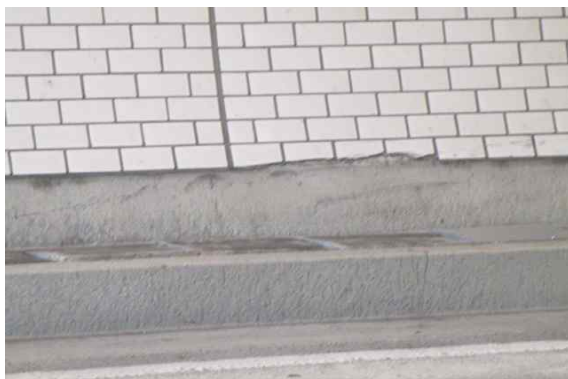
측벽부 SPAN.104 타일파손
