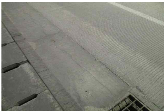
포장부 SPAN.20 균열(0.3mm 이상)
