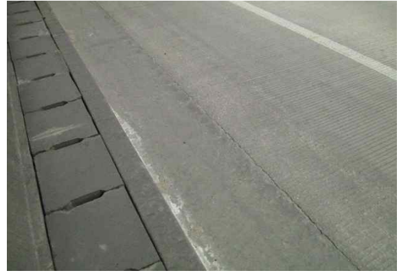
포장부 SPAN.48 균열(0.3mm미만)
